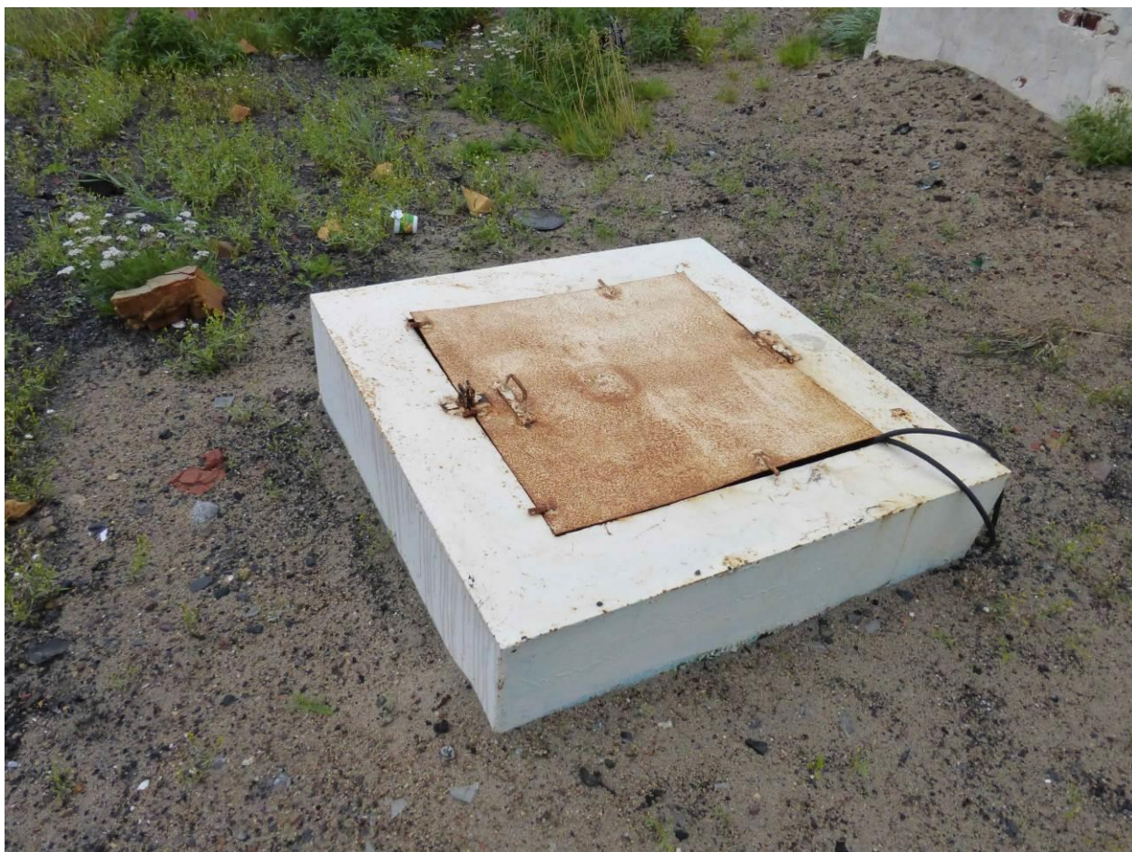
Рисунок 2.2.1.3 – Водозаборный колодец в с. Териберка (р. Териберка)
